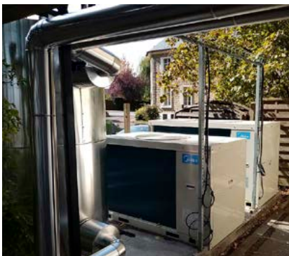
Lieu : Versailles Unités extérieures : Chillers
